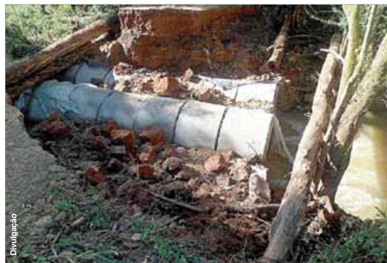
Ponte de Água Clara foi danificada e impede a passagem de ônibus escolares.
